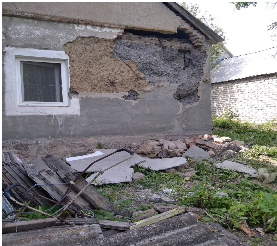
Фото 15. Будинок після обстрілу село Гранітне. [3.6]
