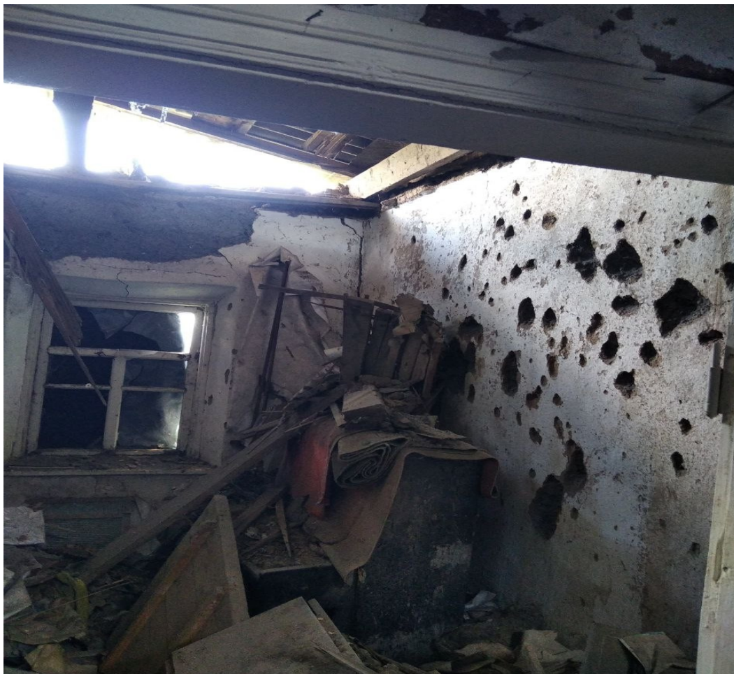
Фото 12. Будинок після обстрілу село Гранітне. [3.3]
