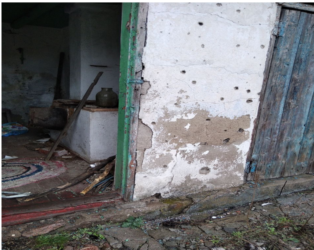
Фото 11. Будинок після обстрілу село Гранітне. [3.2]
