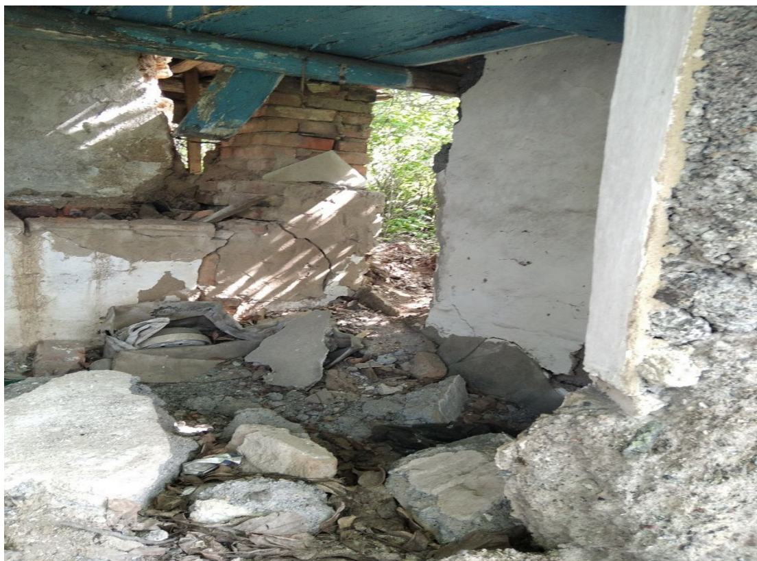
Фото 13. Будинок після обстрілу село Гранітне. [3.4]
